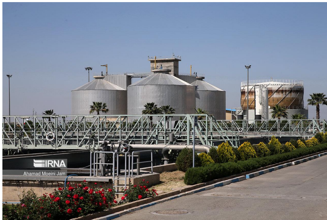
راکتورهای بیهوازی در تصفیه خانه فاضلاب جنوب
