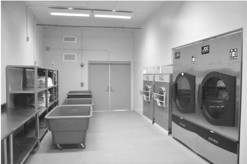
تصویر ۴-۷: اتاق تجهیزات لباس شویی در بخش رختشوی‌خانه
