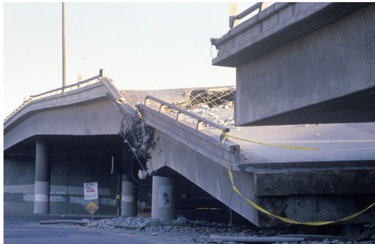
شکل ۳: پس از زلزله با فروریختن پل‌ها و تخریب زیرساخت‌های حمل و نقلی، دسترسی به برخی مناطق محدود می‌شود.
