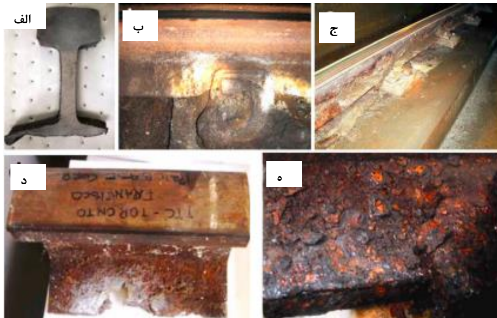
شکل 2. مثال‌هایی از خوردگی در مسیر ریل [14].
