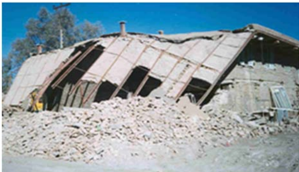
شکل (۲): آسیب ناشی از پایین بودن کیفیت چسبندگی ملات [۱۶].
