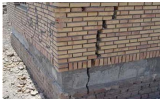
شکل (۷-ب): مکانیسم آسیب در تقاطع دیوار محصور [۱۷].
