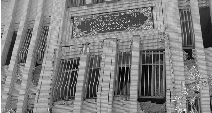
ساختمان ثبت اسناد شهرستان بزم که بر اثر زلزله از کاربری خارج شده است.
