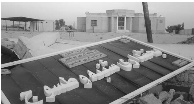
ساختمان بخشداری شهر شنبه که در زمان زلزله شنبه بوشهر به شدت آسیب دید.
